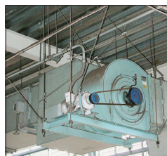
振れ止め交差金具施工例
